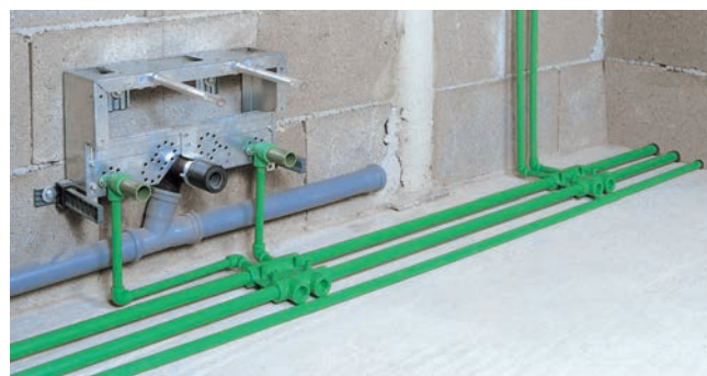
Распределительный блок для водоснабжения
