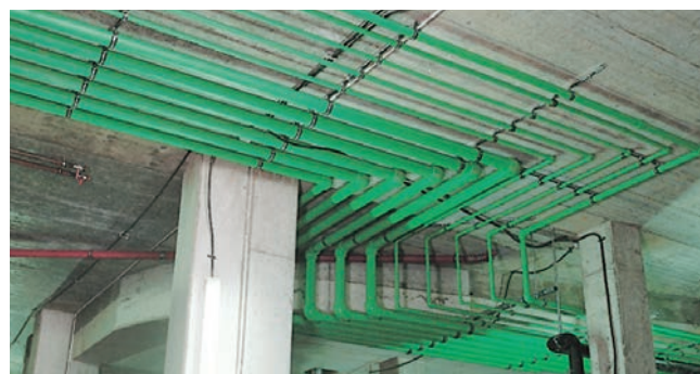
Трубопроводные линии для этажей
